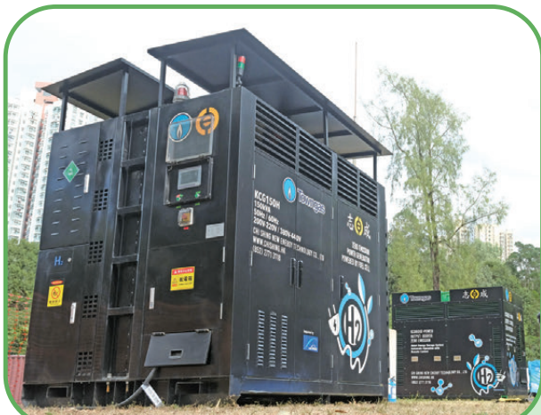
●Towngas與合作夥伴研發的一體化氫能發電機，成功為全運會香港賽馬場地提供清潔電力。此技術可在建築工地應用，取代高碳排放的柴油發電機。
