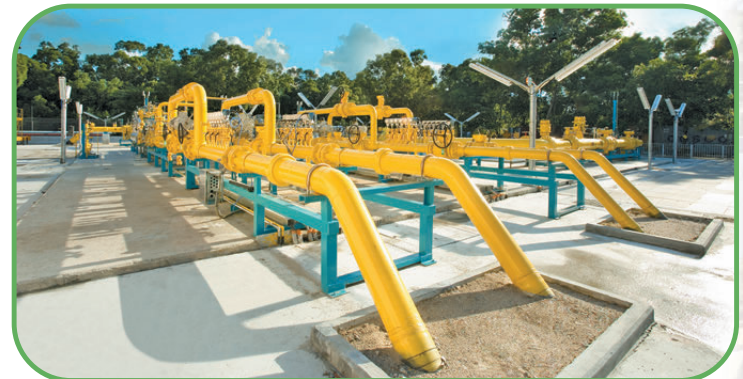
●大埔製氣廠內設有大型液化天然氣接收站。Towngas現時主要以較潔淨的天然氣作為製氣原料，從源頭大幅降低生產過程中的碳排放。
