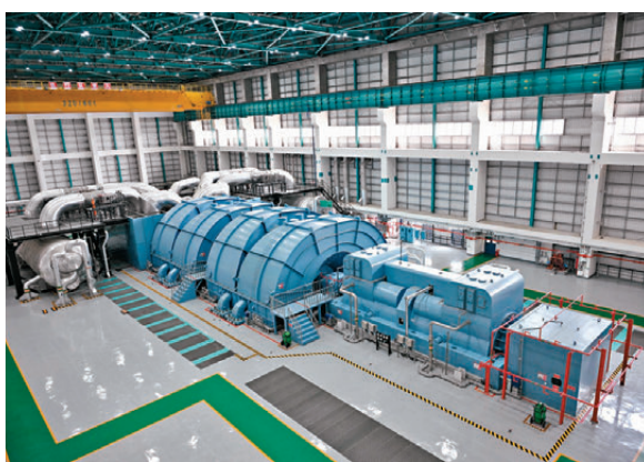
●中廣核廣東太平嶺核電項目規劃建設6台「華龍一號」核電機組，分三期建設。圖為20日拍攝的中廣核廣東太平嶺核電項目1號機組汽輪發電機。
