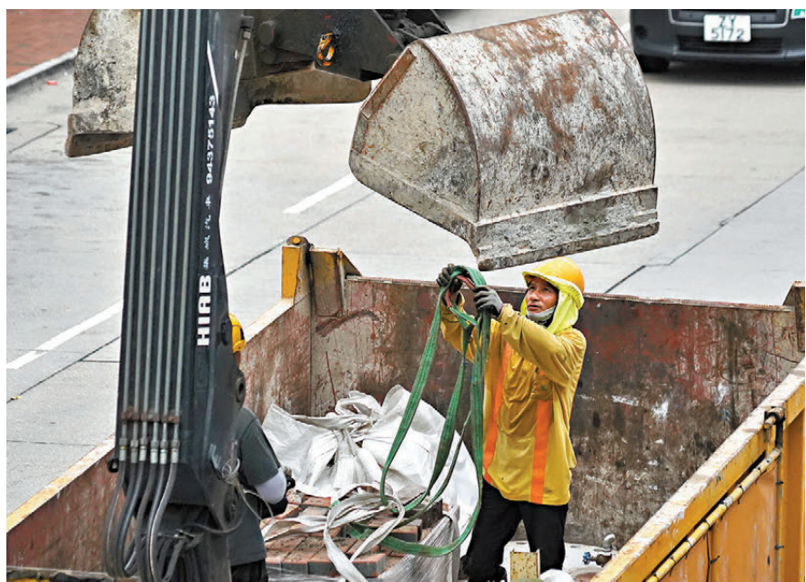
● 工人注視上方巨大的夾斗，利落地整理吊索。以專業與汗水，築起城市建設的基石。香港文匯報記者曾興偉攝
