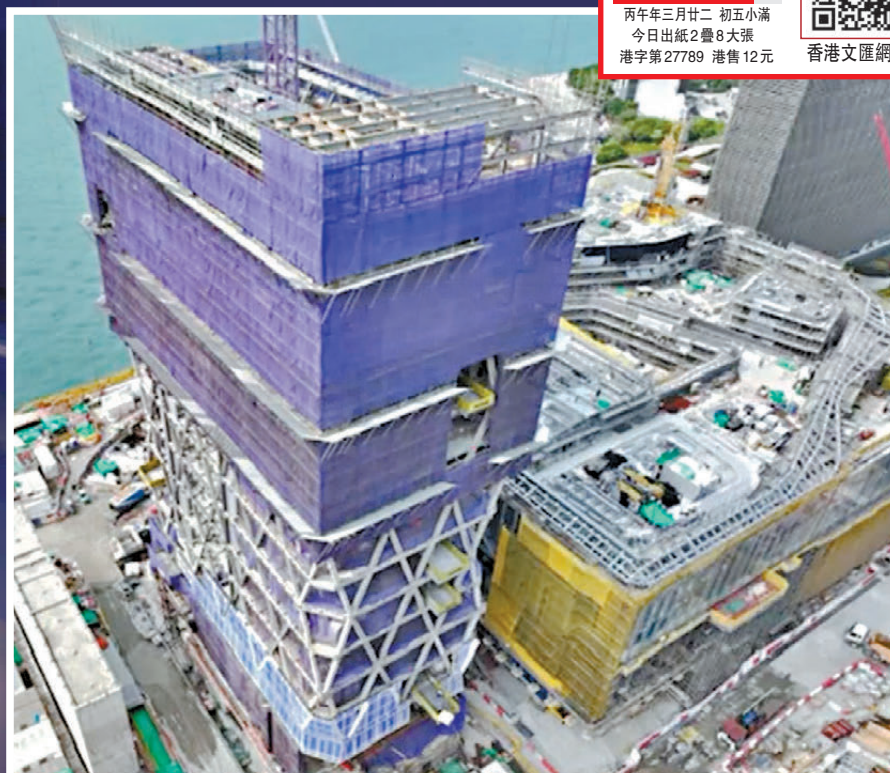
●西九演藝中心(黃色圍網)預計今年內竣工，而藝術廣場大樓(紫色圍網)則預計2027年內完成。 西九管理局圖
