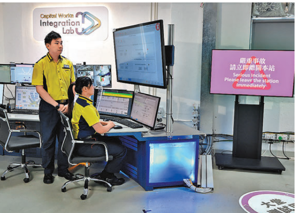
●車站控制室測試區連同大堂測試區，模擬機件故障時的資訊顯示。
