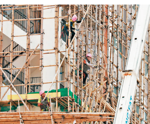
●三項法例修訂將對建築工程總承建商、分判商及任何人施加明確法律責任。圖為工人在地盤搭棚。資料圖片
