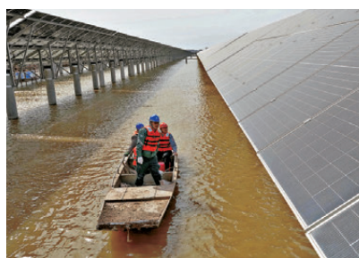
●早前滄州供電公司的工人在光伏發電場巡檢。
