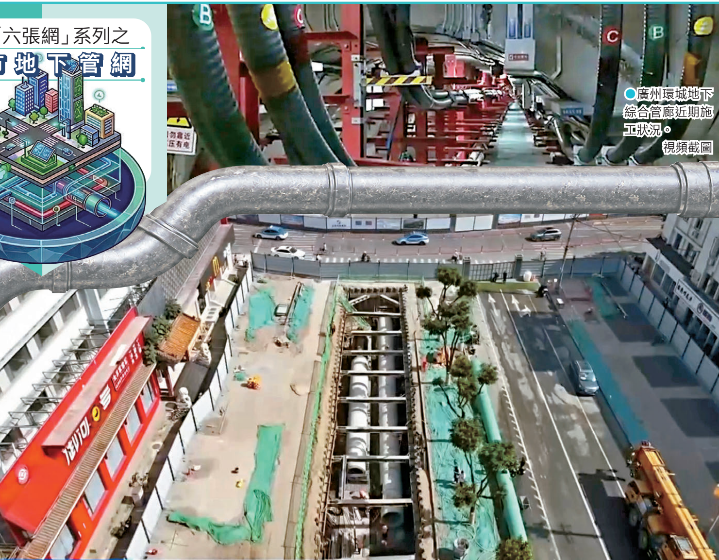
●廣州環城地下綜合管廊穿越荔灣、越秀、白雲、天河與海珠五個主城區，為城市供電、供水及通信提供核心動脈。 視頻截圖
