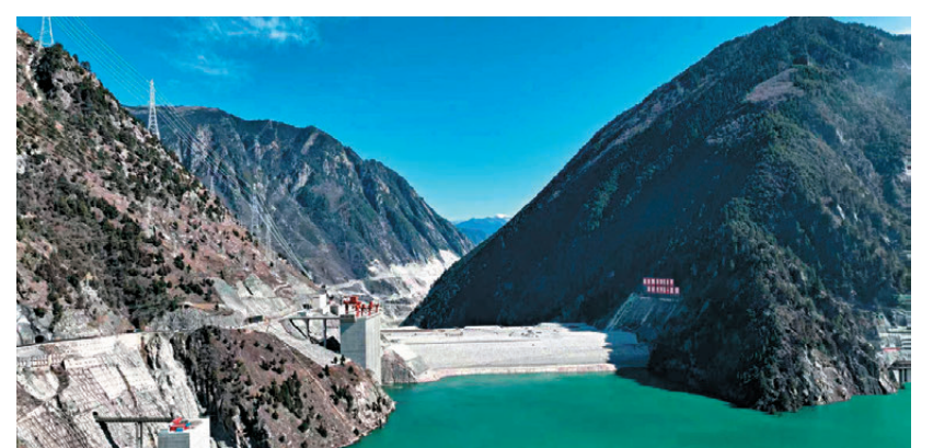
●6月26日，國家能源集團大渡河雙江口水電站首台機組順利實現併網發電。圖為大渡河雙江口水電站建設現場。 新華社
