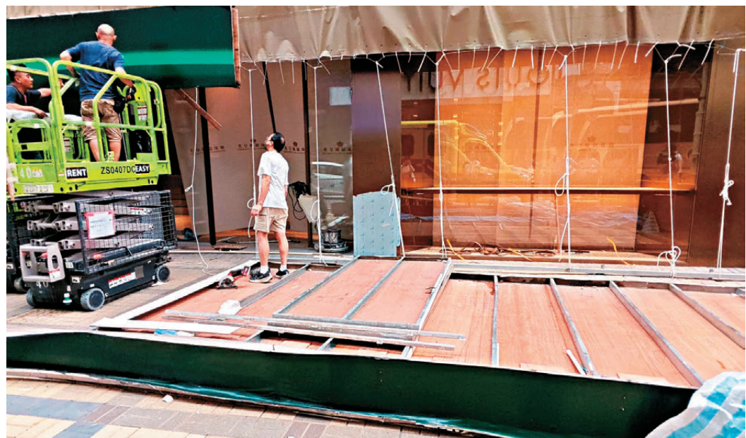
▲尖沙咀廣東道一幅大型圍板昨日倒塌，壓傷一名女途人。 香港文匯報記者劉友光攝
