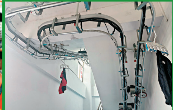
●廣州希利服飾有限公司的樓梯間，抬頭可以看到貫通樓宇間的懸掛式智能衣架高速運轉。
