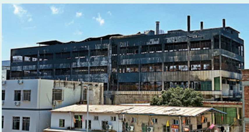
●發生火災的廠房上三層外牆瓷磚脫落嚴重，尤其頂層最甚；外牆一片焦黑，外立面玻璃全部爆裂。
