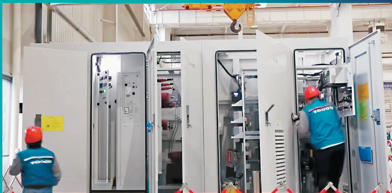
●中國硬核電力黑科技「預製變電站」在全球市場爆單。
