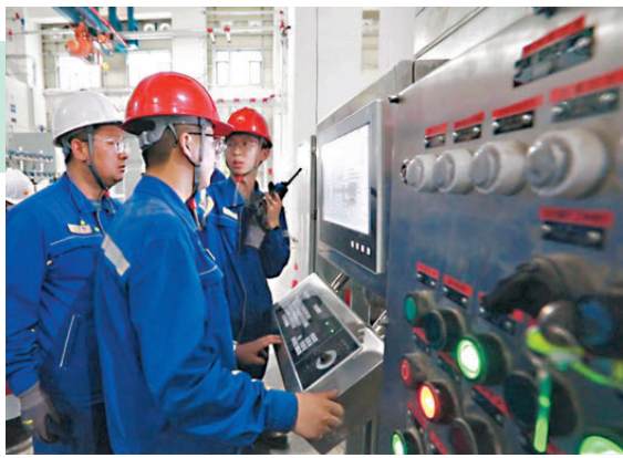
●塔里木120萬噸/年乙烯工程電驅壓縮機房。
