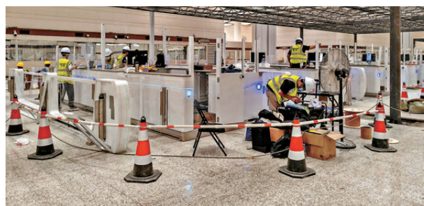
●新口岸實施「合作查驗、一次放行」模式。圖為工作人員檢查聯檢大樓設備。資料圖片
