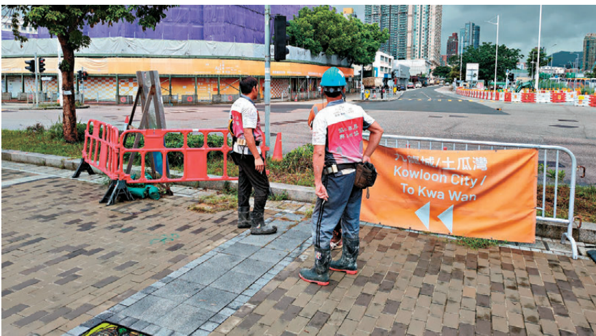
● 工地禁煙實施首日，有工友在地盤外吸煙。
