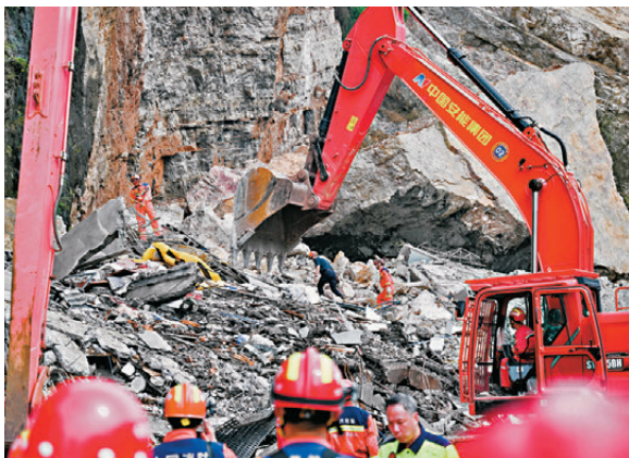
●7月17日9時10分許，重慶彭水縣漢葭街道發生一起山體崩塌，造成多人被埋失聯。救援進入第二天，多方力量在現場繼續加緊救援。圖為7月18日，救援人員在現場救援。
