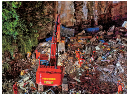
●7月18日夜間，救援人員在重慶彭水縣山體崩塌現場救援。
