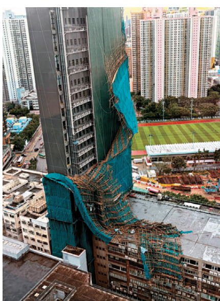
●長沙灣道750號一大廈地盤有巨幅棚架倒塌。香港文匯報記者黃宇威攝
