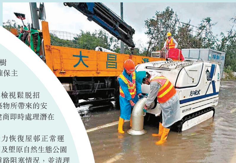
▲ 渠務署緊急應變隊伍在強力排水機械人「龍吸水」協助下，於沙頭角公路一帶處理水浸。 渠務署 Fb
