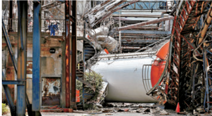
●直徑達4米的煙囪倒在建築物上方。 美聯社
