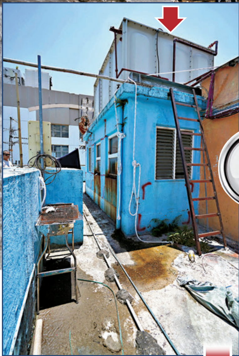
●消防水缸（上方白色物件）滲漏的水沿排水喉和梯屋牆體流到天台地板，即使烈日當空也是滿地水漬。 香港文匯報記者曾興偉 攝
