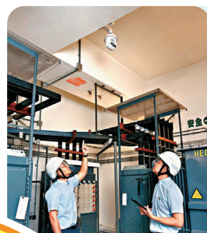
●「港燈智慧電網通」與LENS系統，讓變電站和事故現場狀況可視化，大幅提升電網管理效率。 港燈供圖
