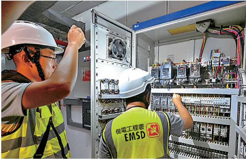
●機電署人員日前在模擬停電的演練中緊急維修電力系統。 政府新聞網圖片
