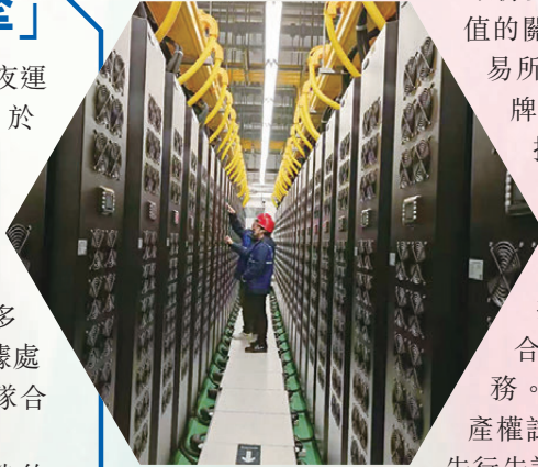
●工作人員在超算中心機房檢查設備運行情況。
