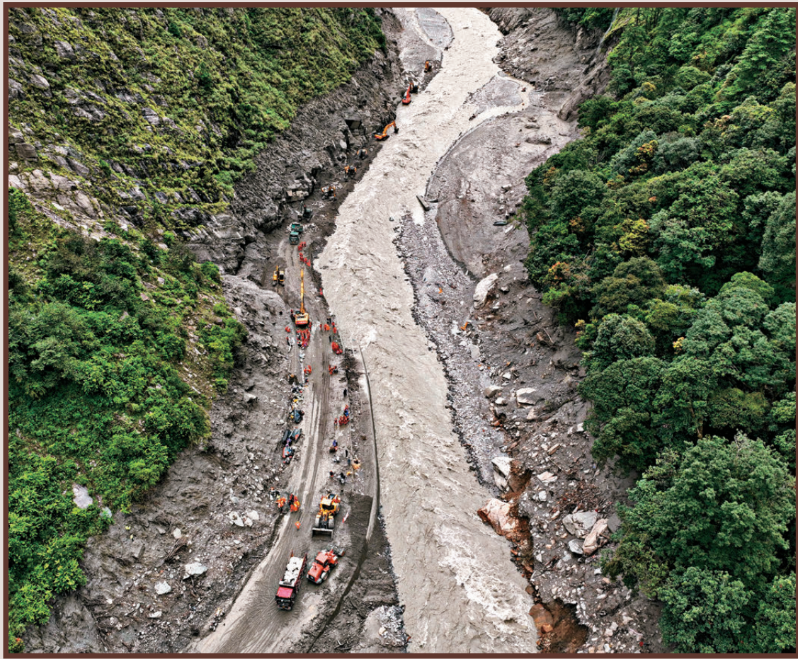
● 8月29日，救援力量持續對G216國道損毀路段全力開展搶通作業（無人機照片）。
