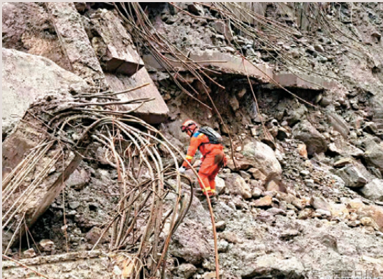
●吉隆口岸大樓只剩鋼筋骨架。救援人員在鋼筋骨架中仔細搜尋，在現場開展拉網式搜救。網上圖片
