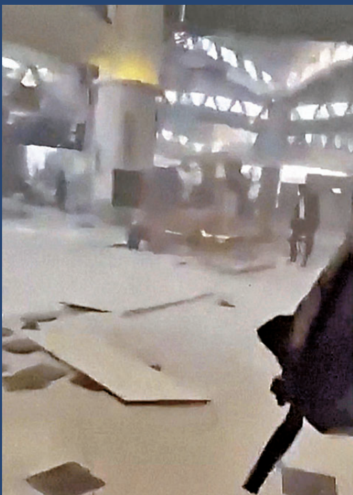
●機場部分天花倒塌。
