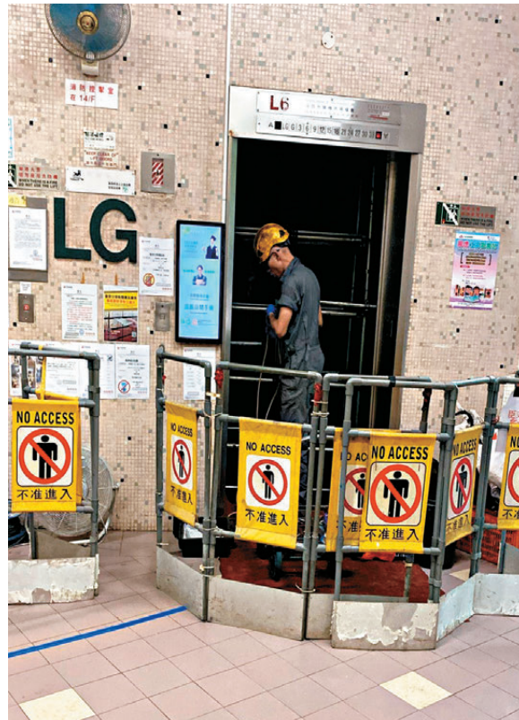
●入伙多年的鑽石山鳳德邨，過去一年連番出現升降機故障，36部住宅升降機輪住壞。
